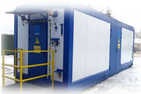
Блок-контейнеры электропитания БК (УГП)
